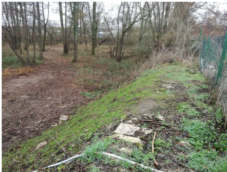
Digue quelques semaines après intervention de la régie intercommunale
