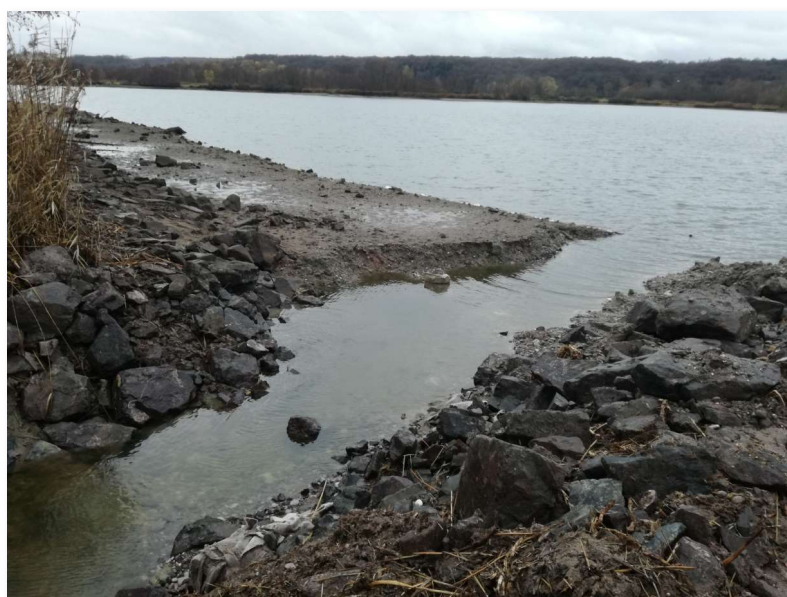
Echancrure en travers de la berge
